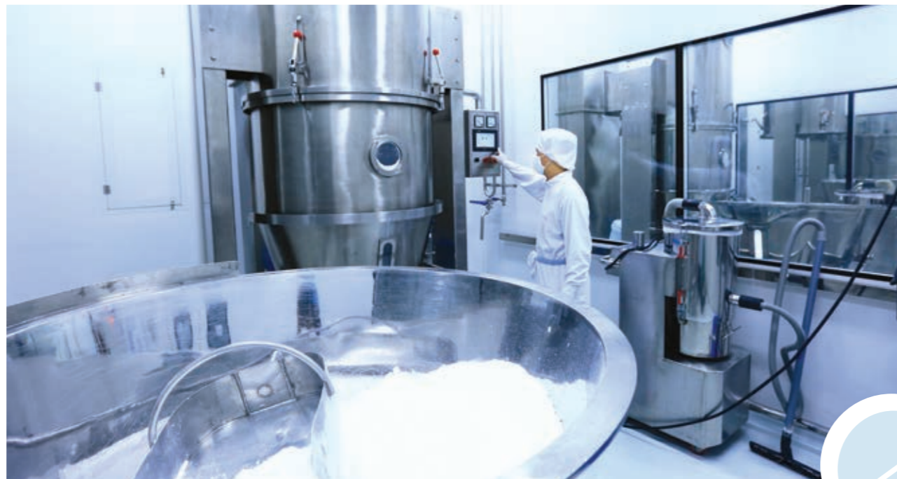
Máy sấy tăng sôi tại Nhà máy sản xuất DHG Pharma.
