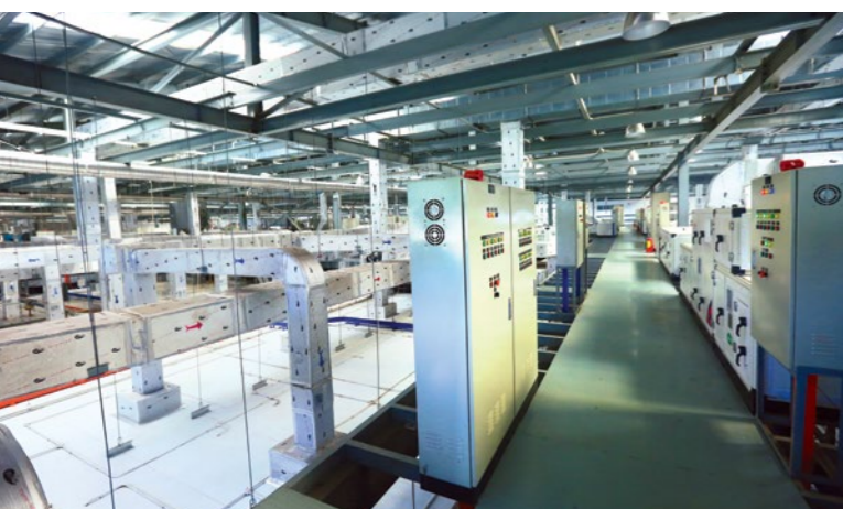
Tầng kỹ thuật bên trong nhà máy sản xuất thuốc DHG Pharma.
